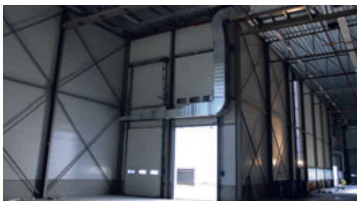
3. De deuren zijn voorzien van luchtgordijnen met eigen luchtbehandelingskasten.
