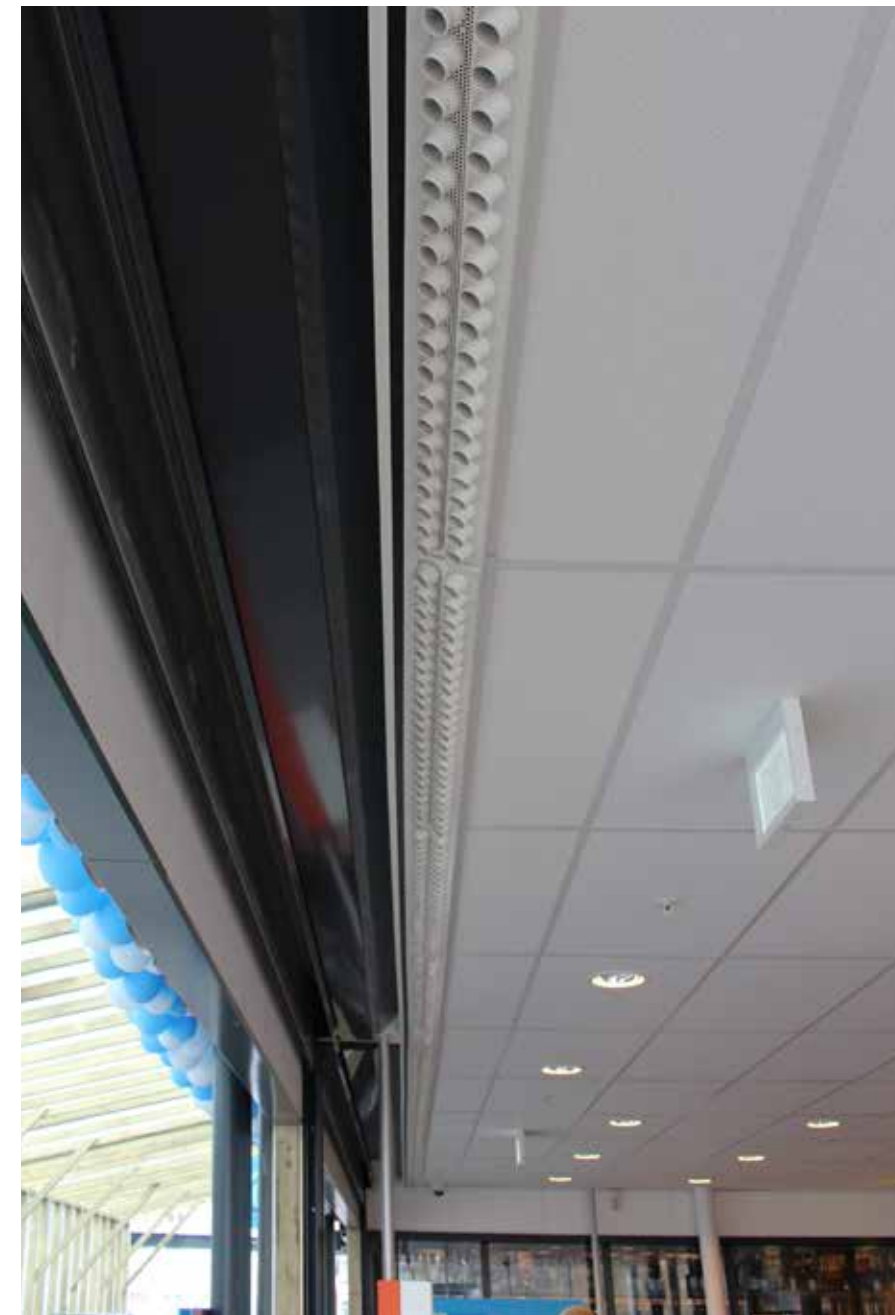
13 meter lang, 500 geïnstalleerde jets.
